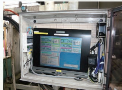
(上・下)フロン類回収監視システム
